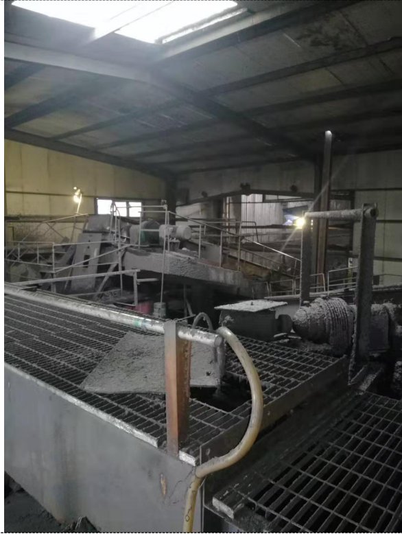
煤泥输送泵房
